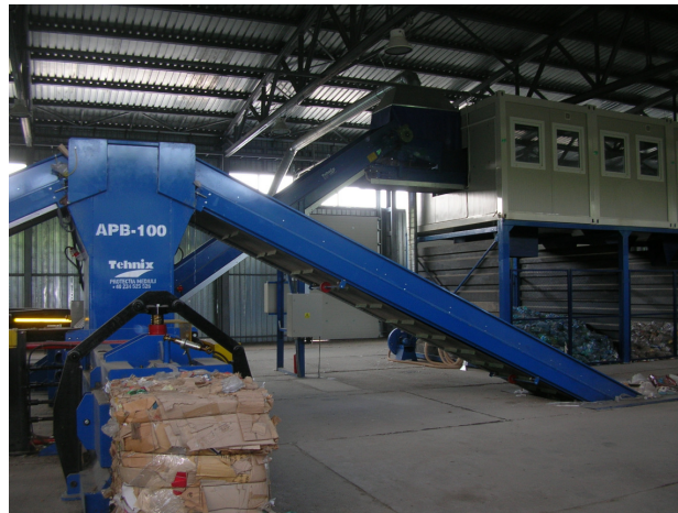
Stația de sortare a deșeurilor-mun. Galați
